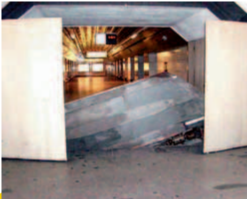
Poloha uzávěru po jeho utržení. Deska tlakového uzávěru tohoto typu váží okolo deseti tun, podobnou váhu mají i protizávaží.
