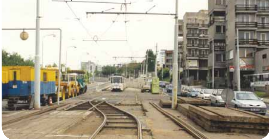
Provizorní úvrat' při opravě zárubních zdí dne 7. května 1999. Foto: Jan Šurovský
