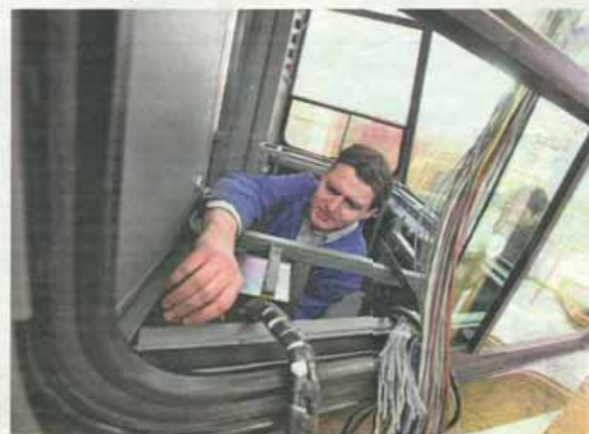
PRAŽSKÉ DĚLNÝ Opravní ústředí i o několik dalších zakázek. Jde například o opravu tramvají T3 pro ukrajinský Char'kov a Kyjev, vedení dílen stojí i o renovaci vozů pro Göteborg. IL. FOTO: HN - J. VOSTRÁK
