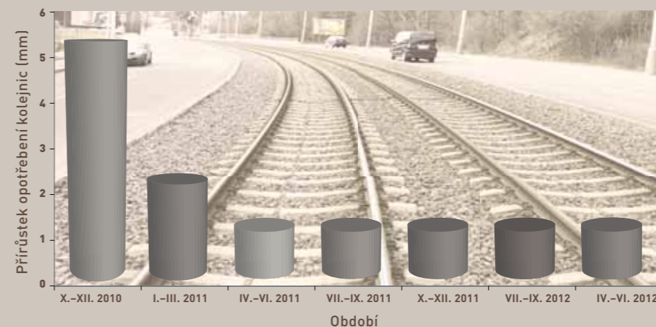
PRŮBĚH OPOTŘEBENÍ KOLEJNIC: oblouk před zast. Krematorium Motol – směr z centra
