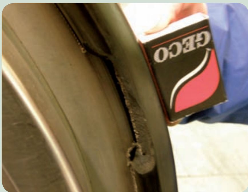
Poškozené madlo ve stanici Malostranská. V porovnání s krabičkou sirek je patrné, jak i relativně malé poškození má vliv na to, že se z bezpečnostních důvodů musí eskalátor odstavit z provozu. Oprava v řádech za desítky tisíc korun.
